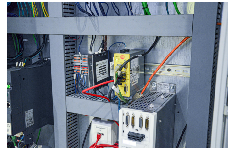
Bramka została zainstalowana w szafie sterowniczej jednej maszyny i połączona w sieć z drugim systemem, dzięki czemu może przetwarzać dane sterujące obu maszyn jednocześnie. (Zdjęcie: ipf electronic gmbh)
