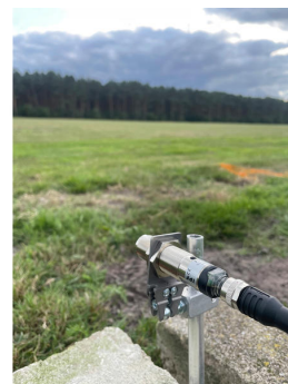
Urządzenia, w tym przypadku odbiornik PE180424 zostały zamontowane przy użyciu uniwersalnego systemu montażu czujników firmy IPF.
