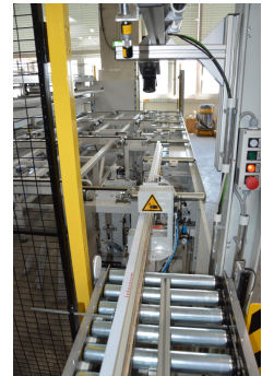
Do rozpoznawania typu profilu służy czujnik kamery OC539621 (góra, środek obrazu) w połączeniu z liniowym wskaźnikiem laserowym PP98C893 (na lewo od czujnika kamery). Oba urządzenia zostały zamontowane na specjalnym urządzeniu do wykrywania profili z góry.
